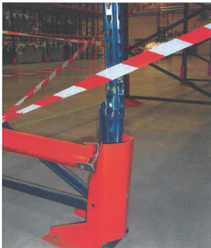
Poteau et sa protection détériorés, à remplacer
