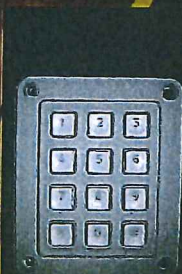
Contrôle d'accès par code
