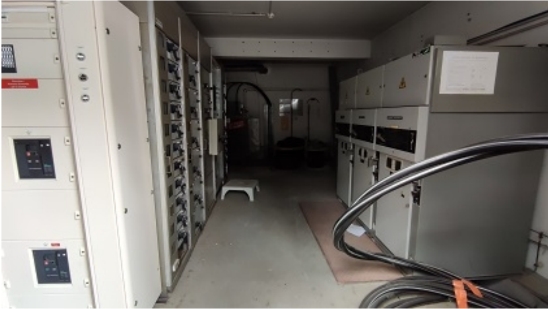
Locaux en sous-sol pour le TGBT
